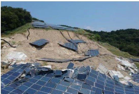
土砂崩れにより太陽光発電設備が架台から崩壊したもの
