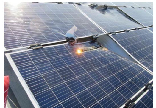
破損部分から発火した太陽光パネル
