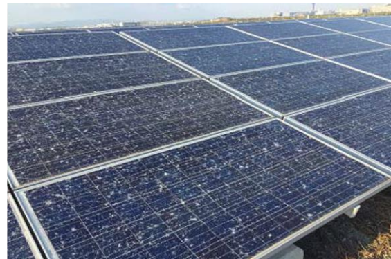
台風による暴風で太陽光パネルが割れた様子
